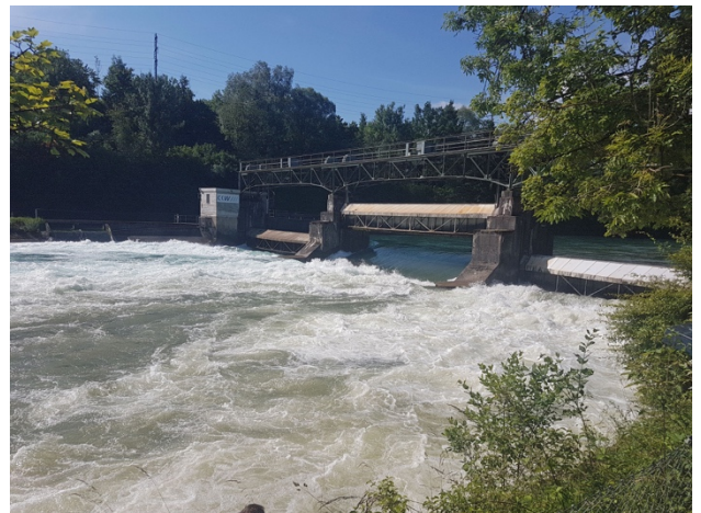
Rathausen-Wehr Durchfahrtsschütze geöffnet zwei Seitenschützen nur teilweise geöffnet
